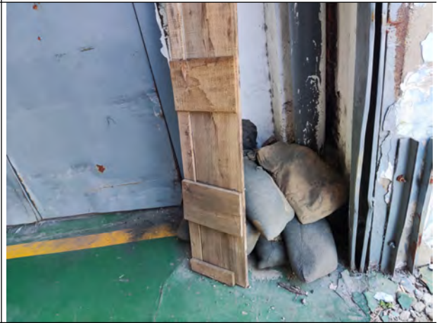
挡板、沙袋（生产车间）
