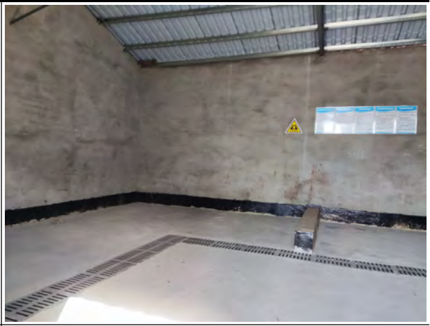
导流沟（危废暂存间）
