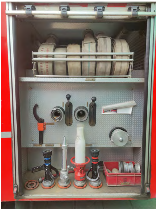
消防水带、水枪（保卫部）
